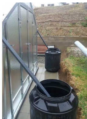
příklad jímání dešťové vody ze střechy skleníku
